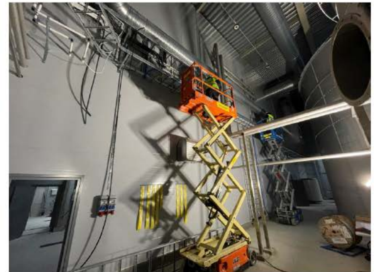
Kabeldragning i processhall
