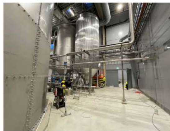
Isolerad och inklädd fettank
